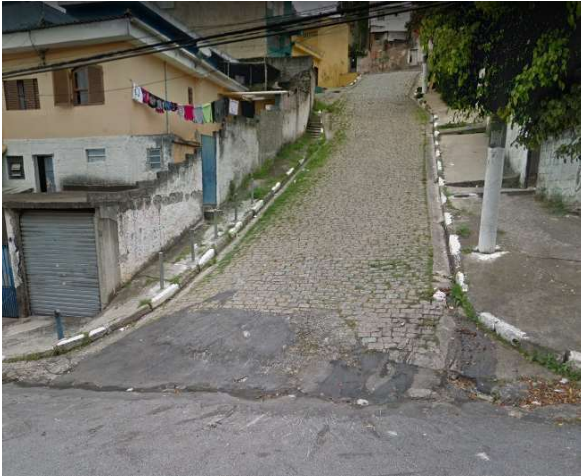
Rua Estocolmo, na esquina com a Rua Copenhaghen: O piso de paralelepípedos fica escorregadio com a chuva; No cruzamento entre as vias, a valeta com diversas marcas de raspagem de para-choque.
